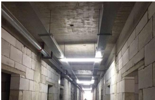
学生宿舍一组团项目 4#楼楼道照明 (2016.4.14)
